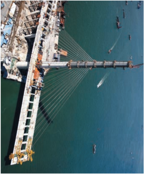
• STONECUTTERS BRIDGE, HONG KONG installazione di Shock Transmission Units
